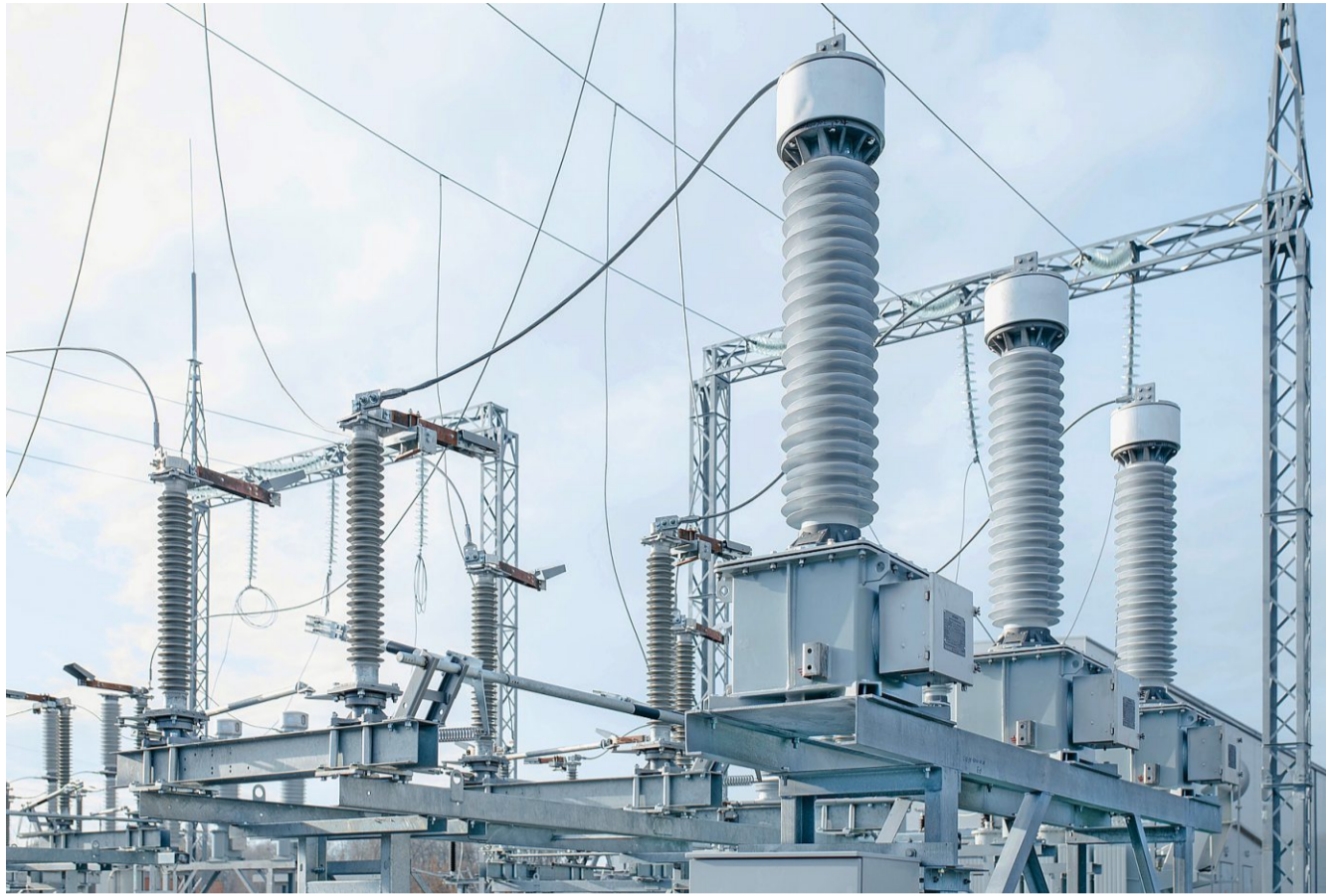
Centiel schützt Unternehmen vor Störungen in den Stromnetzen, was zum Beispiel für Rechenzentren existenziell ist.
